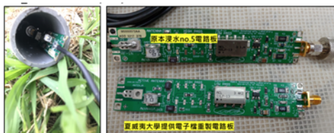
圖4. 5號天線無訊號，左為接收天線端電路板進水，右為重製電路板，更換後正常。
