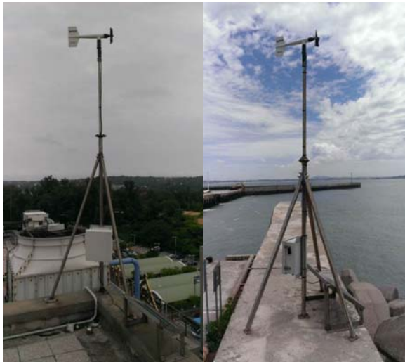
圖4 水頭港旅客大樓風速計(左)九宮港風速計(右)
