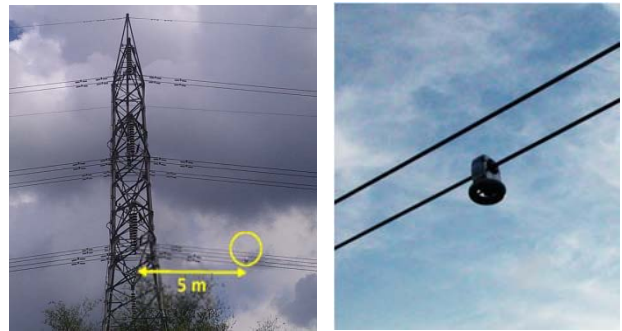
圖2 SMT1實際裝設於輸電線路上的情形(臺灣電力公司，2013)
